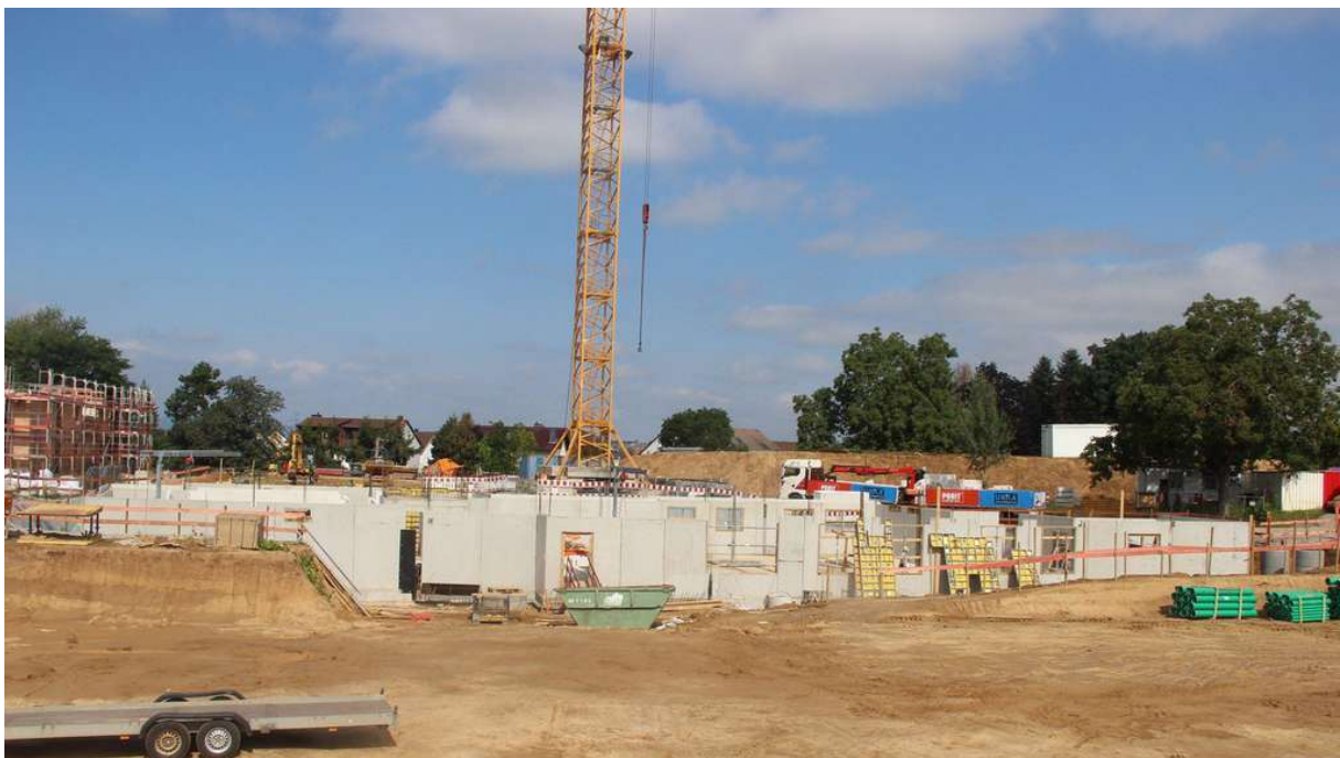
Im April fiel der Startschuss im Baugebiet „Im Bachgange“. Das Kellergeschoss ist längst fertig. © Jürgen W. Niehoff
